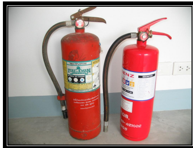
รูปที่แสดง สภาพตัวถังดับเพลิงที่พร้อมใช้งาน
